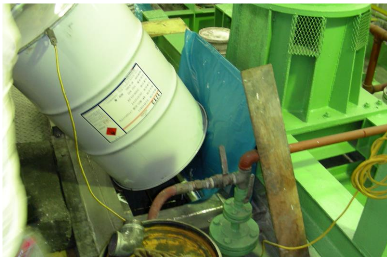
圖 21 落實等電位搭接與接地措施
