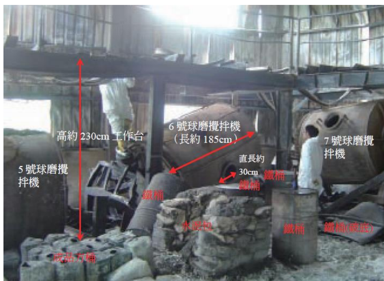
圖 2 防水塗料工廠爆炸後現場
