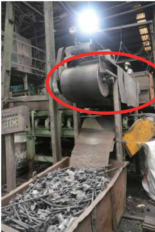
鑄件回爐料磁選機之帶輪 未安裝護罩，易發生捲入災害
