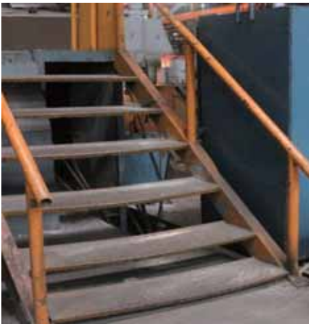
樓梯踏板凹陷， 易造成行走重心不穩而跌倒
