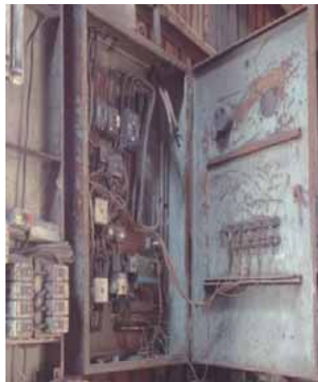
配電箱未置隔板
