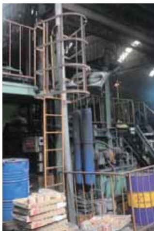
爬梯/作業平台應設置護籠或欄杆等防止墜落危害設施
